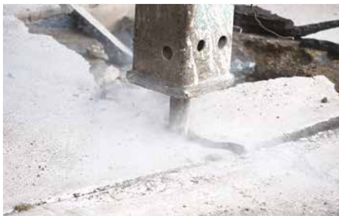
Prach uvoľňovaný pri stavbe plynového potrubia. Ohrozovaní sú najmä robotníci.
